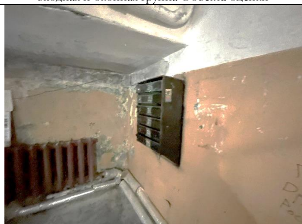
Фото 32. Состояние лестничной клетки
