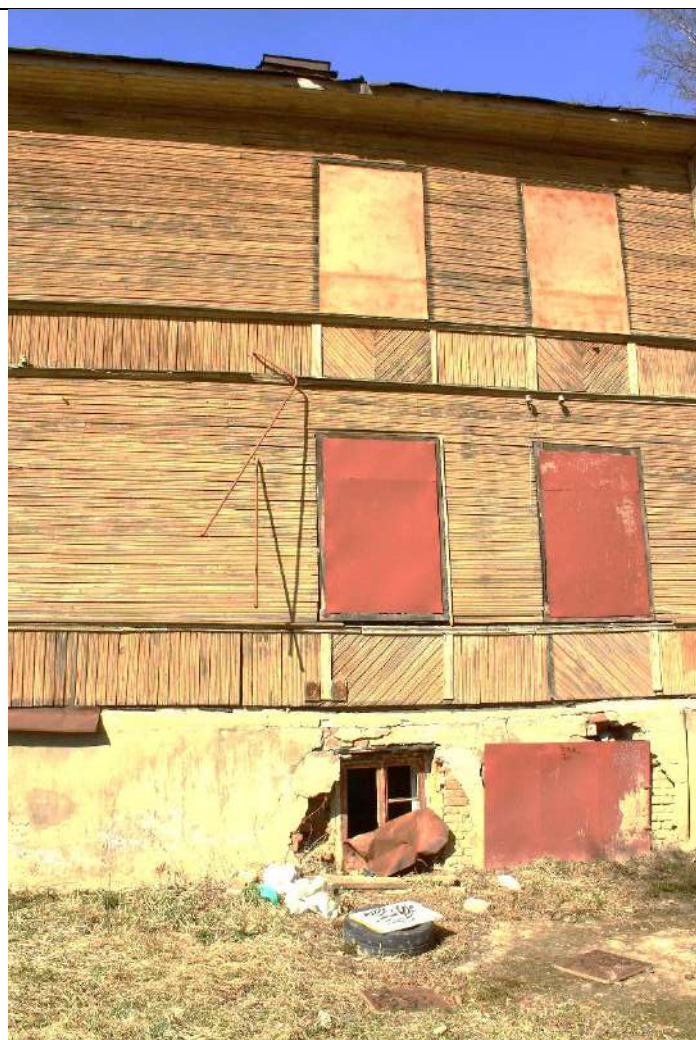
Фото № 7. Вид на фрагмент Восточного фасада с нарушенной обшивкой оконного проема подвала
