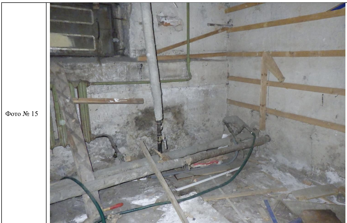
Описание: в ч.п. 12 Объекта транзитом проходят трубы
