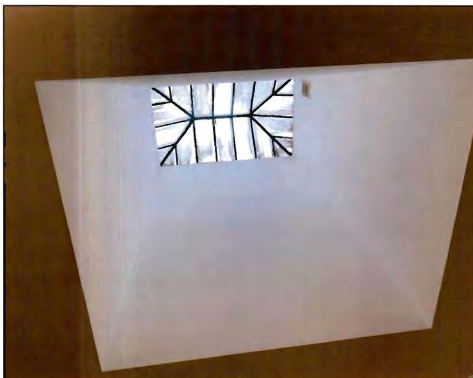
20. Световой фонарь, расположенный над парадной лестницей в южной части лицевого корпуса по ул. Зодчего Росси прямоугольный в плане, с расстекловкой. Фото от 09.11.2021 г.
