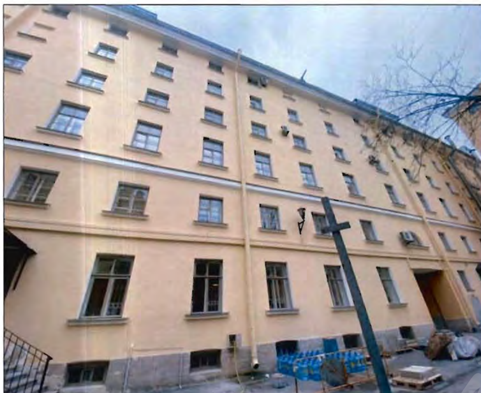
16. Западный дворовый фасад. Дополнительное инженерное оборудование на фасаде. Фото от 09.11.2021 г.
