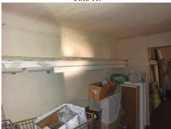
Фото 13. Транзитные трубы в помещении
