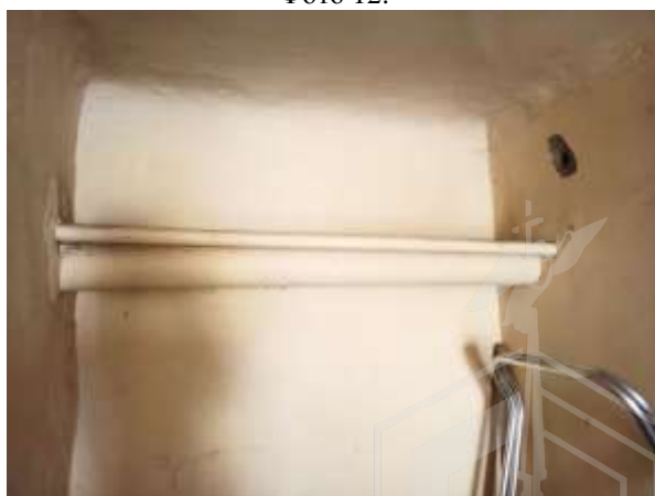
Фото 14. Транзитные трубы в помещении
