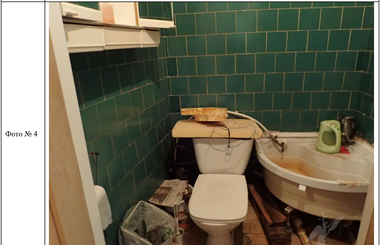
Описание: В ч.п. 2 Объекта установлено сантехническое оборудование
