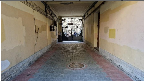
Фото 12. Арка ведущая во двор Объекта оценки (со стороны Бородинской улицы, со двора)
