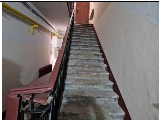
Фото 28. Состояние лестничных проёмов
