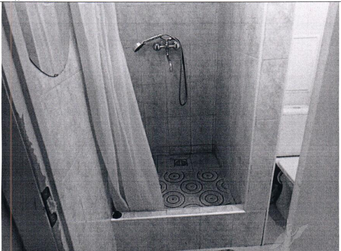
Описание: в ч.п. 2 Объекта демонтировано сантехническое оборудование (раковина); в ч.п. 2 Объекта установлено сантехническое оборудование (душ)
