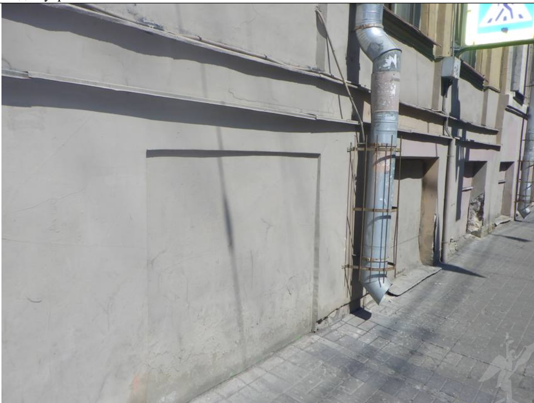
Описание: в ч.п. 4 Объекта заложен оконный проем
