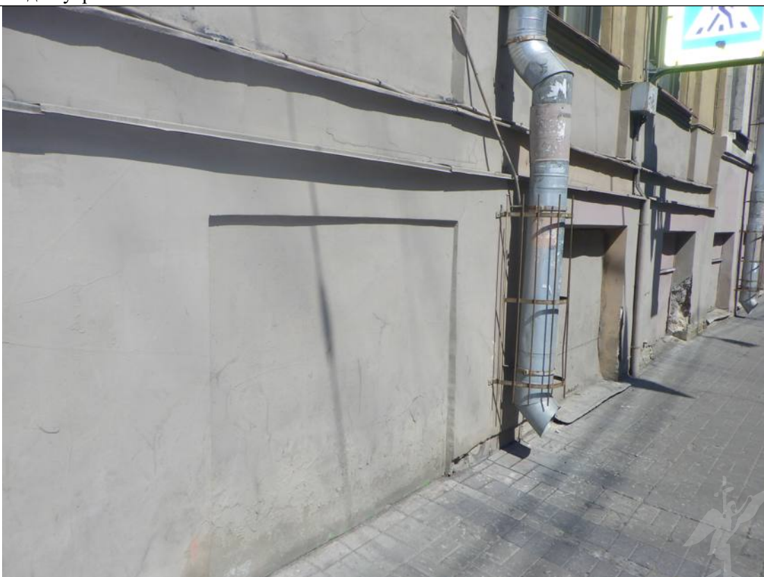
Описание: в ч.п. 4 Объекта заложен оконный проем
