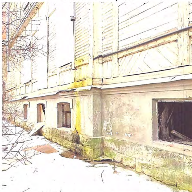
Фото 10. Вид на часть восточного фасада (поврежденные оконные проемы)
