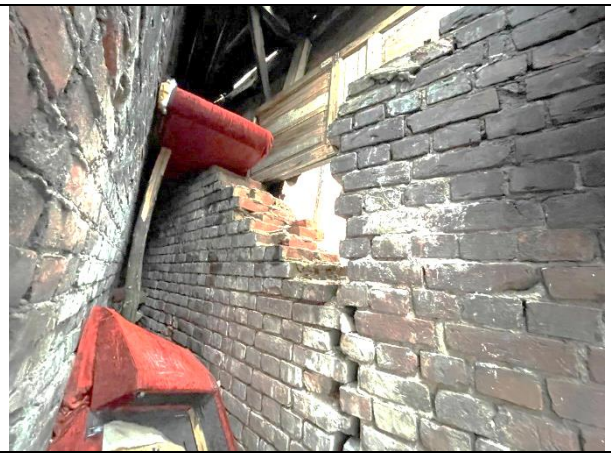
Фото 16. Лаз в стене Объекта оценки
