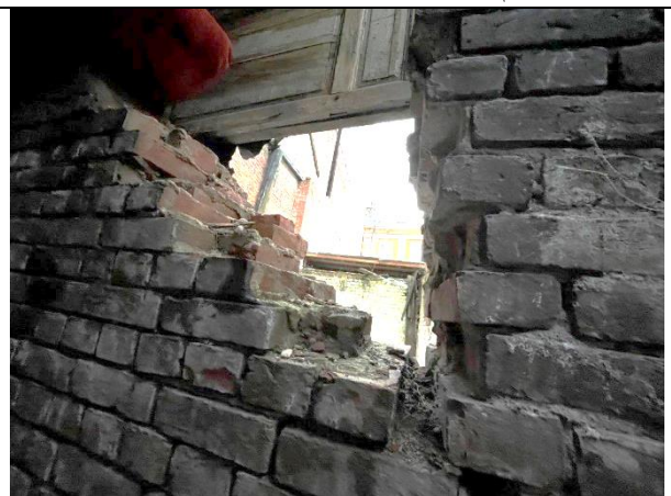
Фото 18. Лаз в стене Объекта оценки
