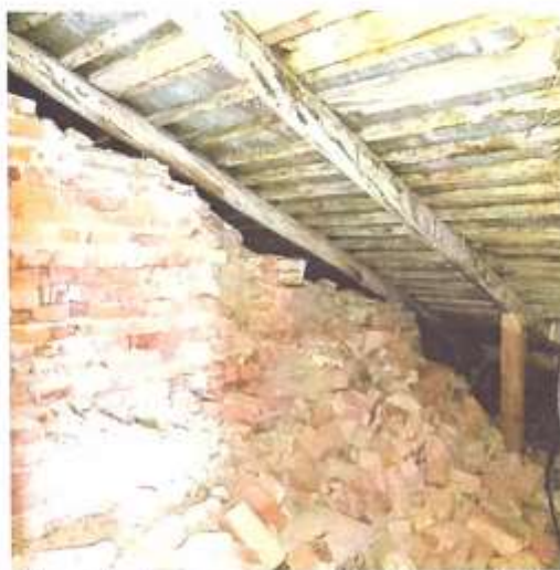
Фото 31. Вид чердачного (подкровельного) пространства, разрушение кладки
