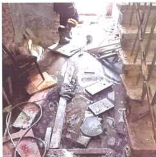
Фото 12. Затопление пространства между входом в ОКН и лестничным маршем
