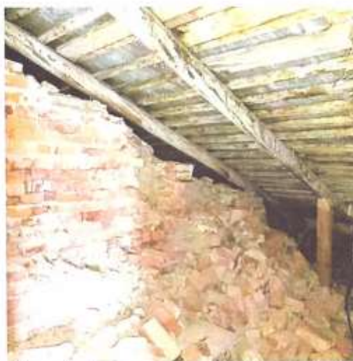
Фото 31. Вид чердачного (подкровельного) пространства, разрушение кладки
