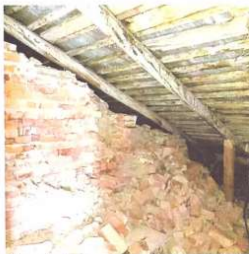
Фото 31. Вид чердачного (подкровельного) пространства, разрушение кладки
