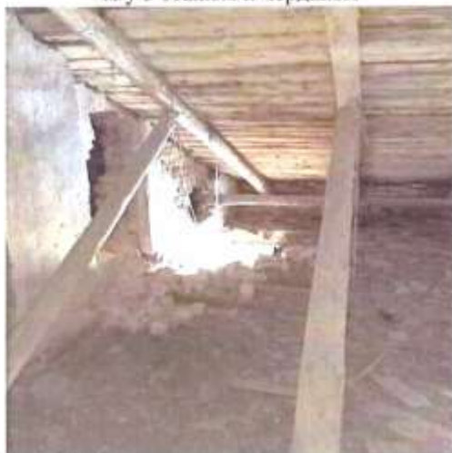
Фото 28. Вид на частичный провал перекрытия м/у чердаком и 3 этажом
