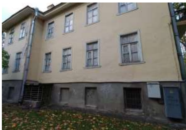
Фото 11. Оконные проемы пом. 3-Н
