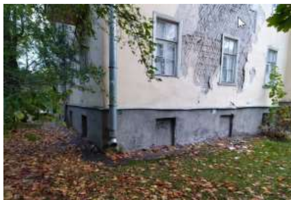
Фото 12. Оконные проемы пом. 2-Н
