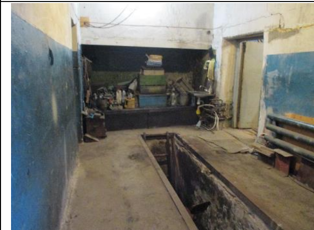
Фото № 35. Внутреннее состояние здания литеры Б
