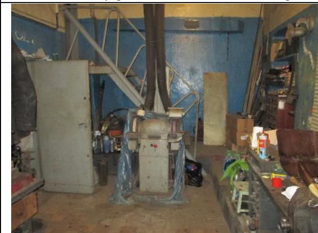
Фото № 37. Внутреннее состояние здания литеры Б
