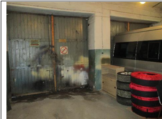
Фото № 41. Внутреннее состояние здания литеры Б
