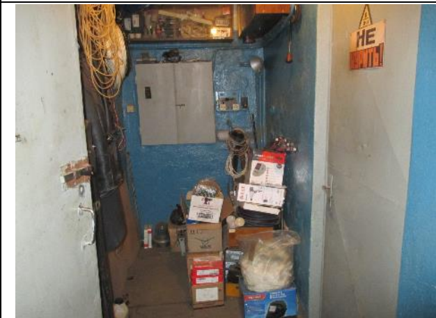
Фото № 39. Внутреннее состояние здания литеры Б
