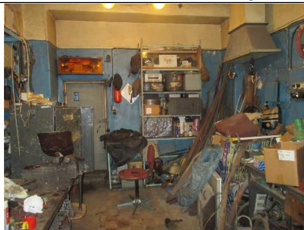
Фото № 38. Внутреннее состояние здания литеры Б
