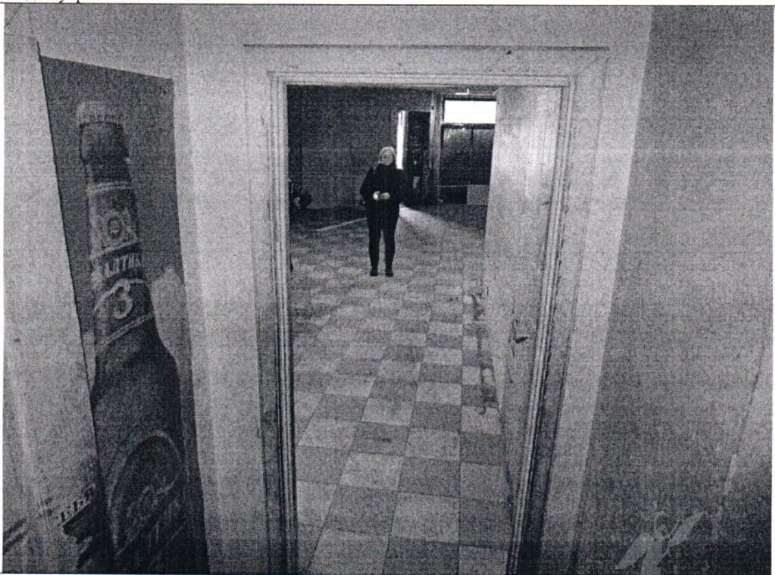
Описание: между ч.п. 1 и 5 Объекта дверной проем переоборудован в проем без дверного блока
