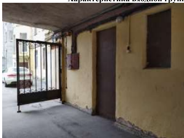
Фото 3. Отдельный вход со двора и окно (заложены) Объекта оценки
