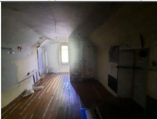
Фото № 13. Внутреннее состояние здание литеры А
