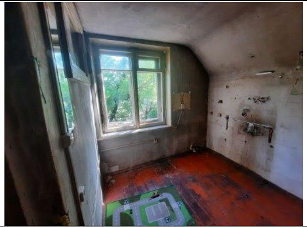
Фото № 10. Внутреннее состояние здание литеры А
