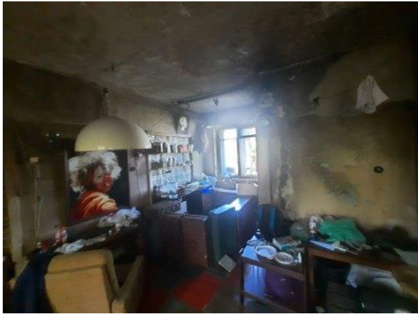
Фото № 11. Внутреннее состояние здание литеры А
