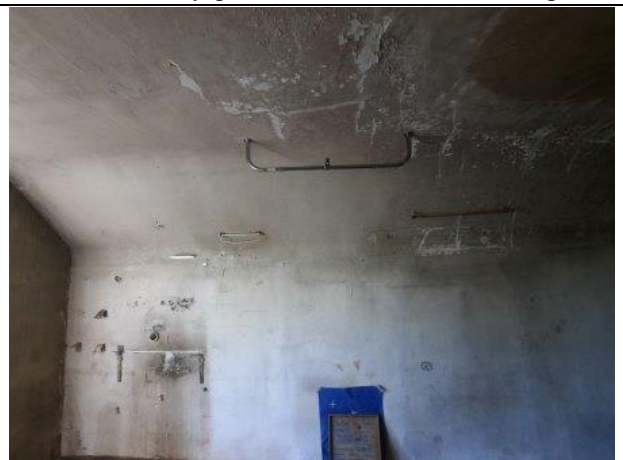
Фото № 14. Внутреннее состояние здание литеры А
