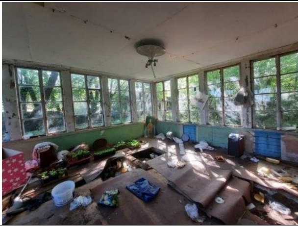
Фото № 9. Внутреннее состояние здание литеры А
