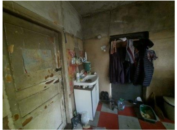
Фото № 12. Внутреннее состояние здание литеры А
