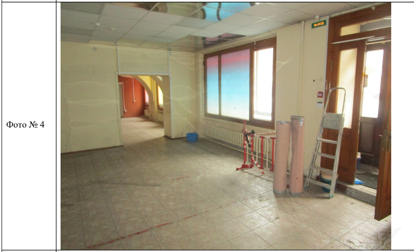
Описание: Внутри Объекта
