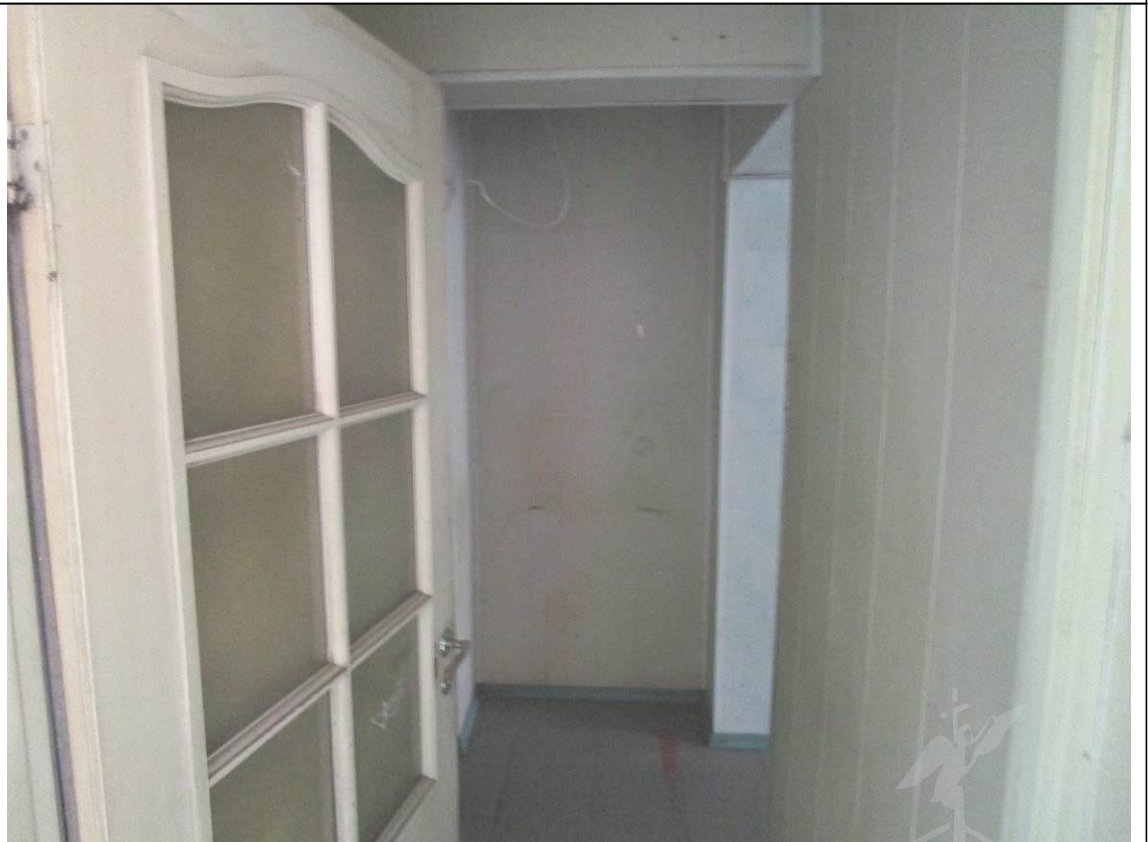
Описание: дверной проем между ч.п. 1 и 2 Объекта переоборудован в проем без дверного блока
