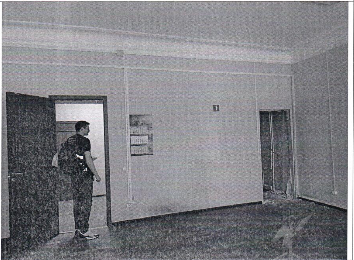
Описание: Между ч.п. 10 и ч.п. 3 Объекта дверной проем переоборудован в проем без дверного блока
