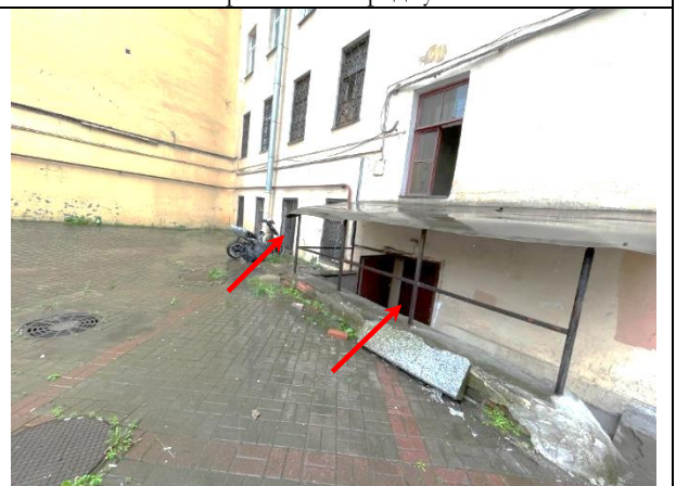
Фото 50. Входная группа Объекта оценки, вход через приямок в парадную, Оконная группа Объекта оценки (окна во двор)
