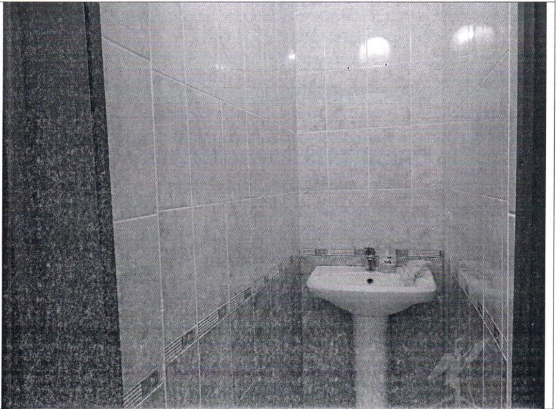
Описание: Вид на ч.п.7 Объекта
