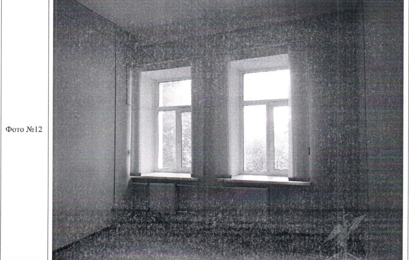
Описание: Вид на ч.п. 2 Объекта
