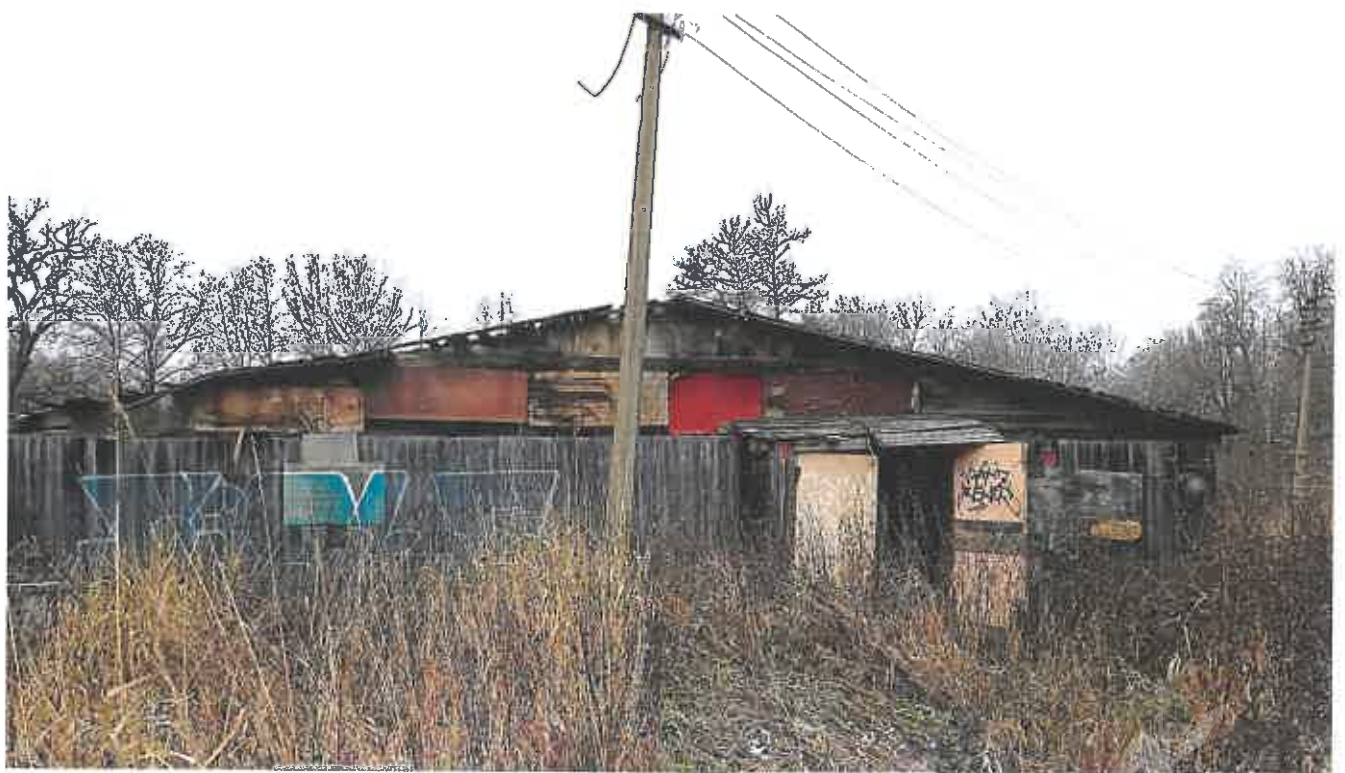
Фото 12. Со стороны восточного фасада. На переднем плане деревянная пристройка, предположительно, самовольная
