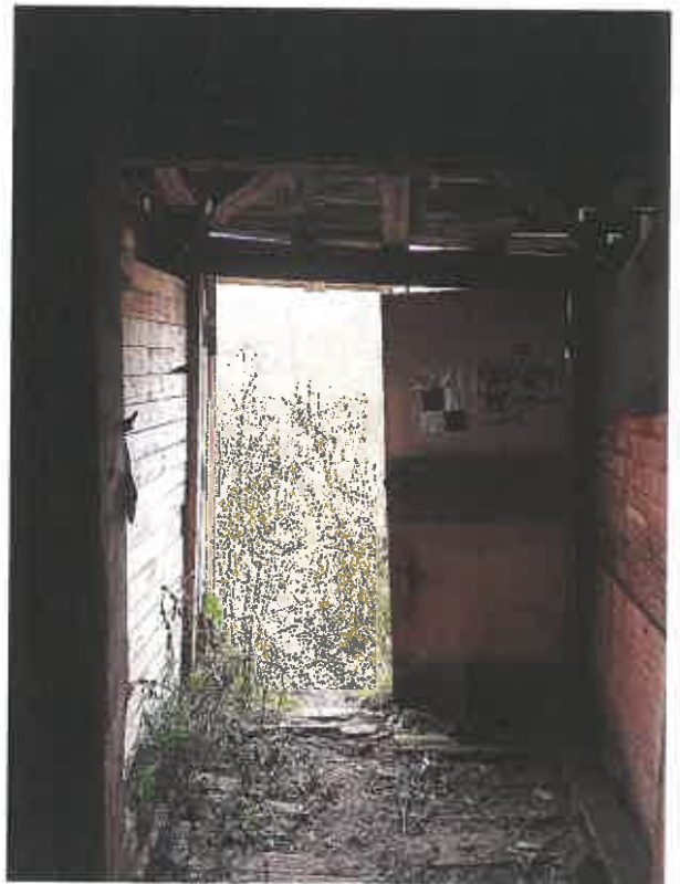
Фото 31. Выход через восточный фасад со стороны помещений самовольной деревянной пристройки к восточному фасаду Объекта
