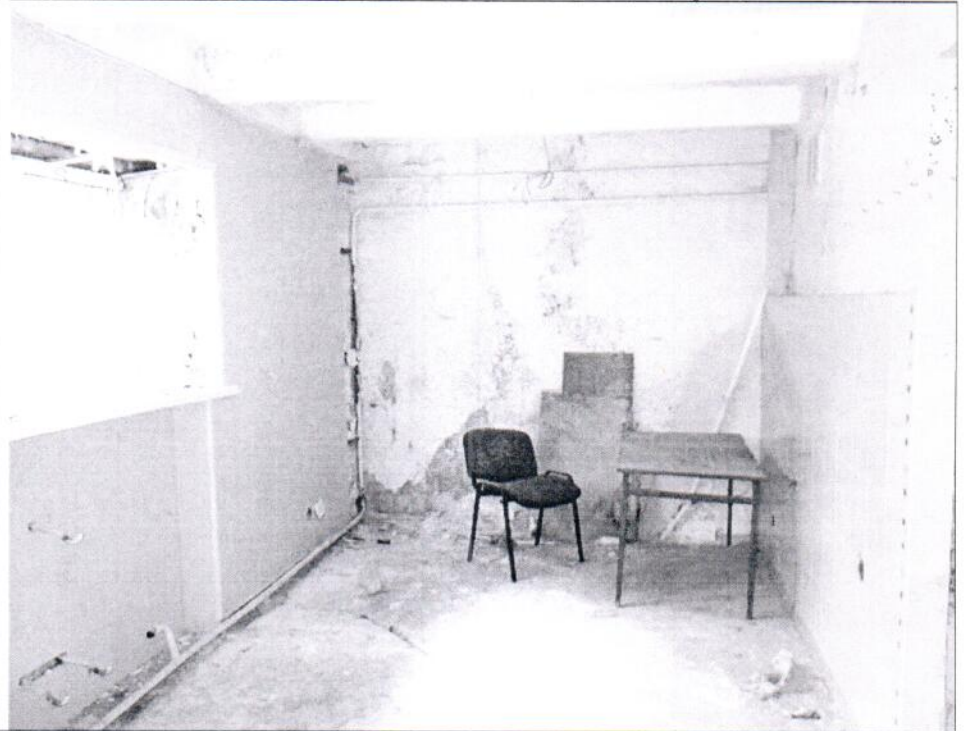
Описание: Вид внутри Объекта (Объект захламлен мусором)
