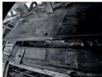
13. Фрагмент восточного фасада объекта культурного наследия. Состояние металлических дверного заполнения
