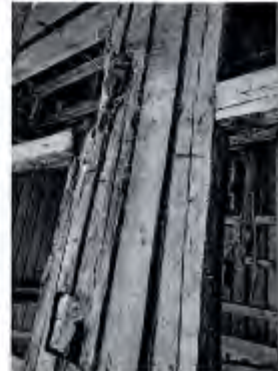
8. Фрагмент фасада объекта культурного наследия. Состояние бревенчатых стен
