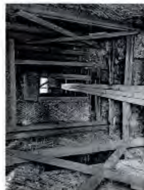
14. Состояние интерьеров объекта культурного наследия
