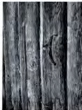
11. Фрагмент фасада объекта культурного наследия. Сохранившиеся элементы потрескавшихся конструкций
