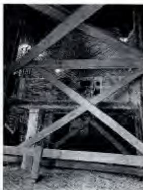
16. Состояние сохранившихся дымоходов
