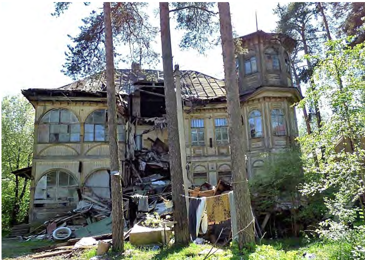
Фото 6. Северный (лицевой) фасад Объекта после обрушения в 2018 г.
