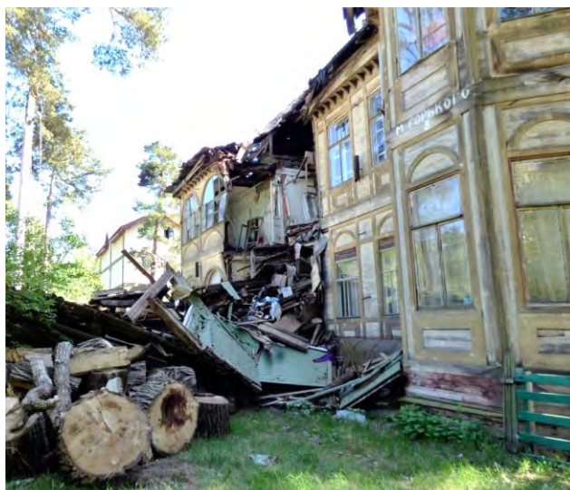
Фото 9. Часть северного (лицевого) фасада Объекта после обрушения в 2018 г.
