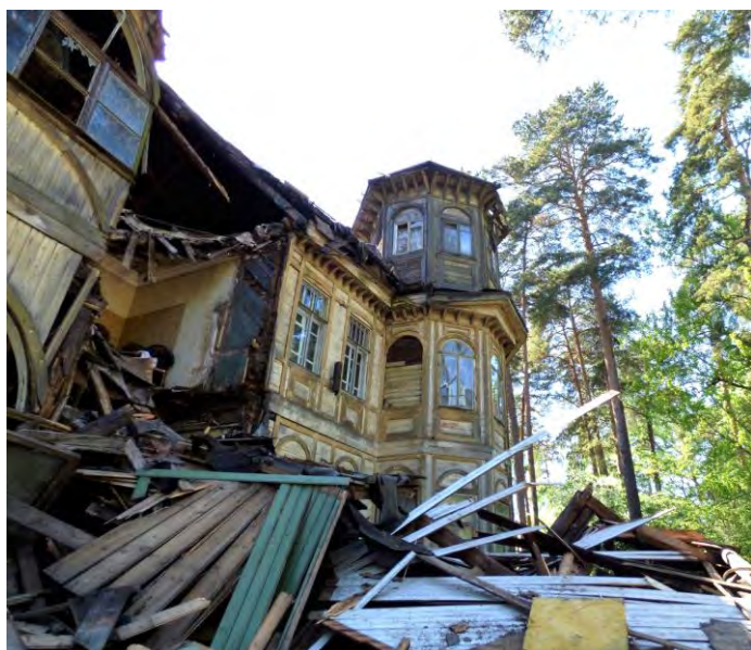
Фото 10. Объект после обрушения в 2018 г.
