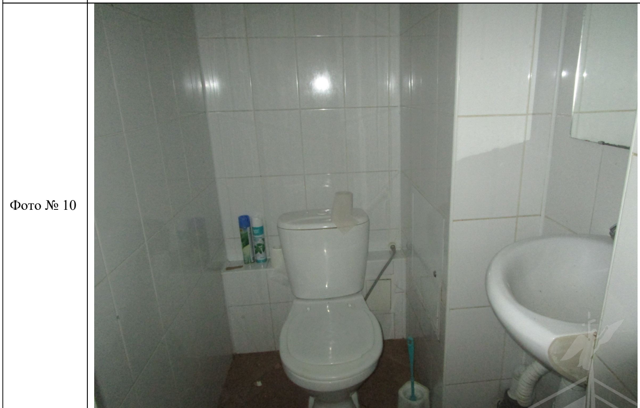
Описание: Внутри Объекта
