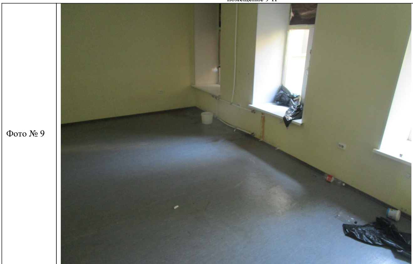
Описание: Внутри Объекта
