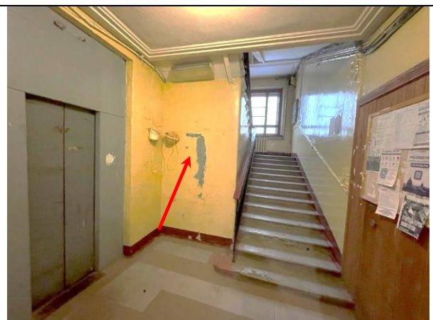
Фото 30. Входная группа Объекта оценки со стороны подьезда (вход зашит)
