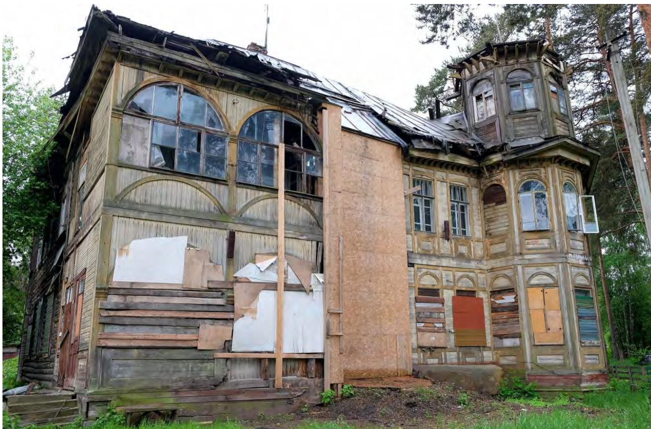
Фото 12. Объект после обрушения в 2018 г.
