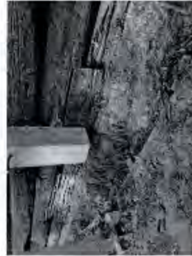
7. Фрагмент восточного фасада объекта культурного наследия. Состояние потолка
