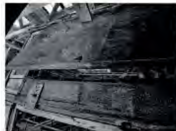
13. Фригмент восточного фасада объекта культурного наследия. Состояние металлических дверного запорения
