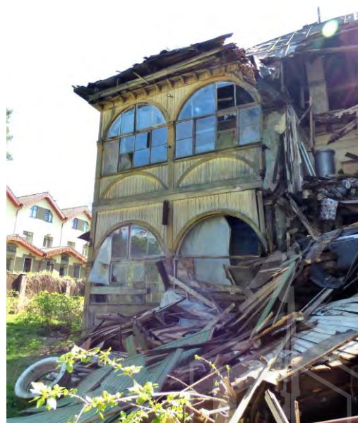
Фото 11. Объект после обрушения в 2018 г.
