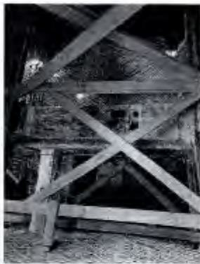
16. Состояние сохранившихся дымоходов
