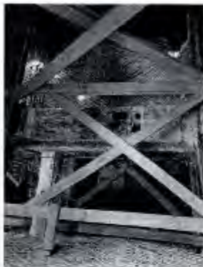
16. Состояние сохранившихся дымоходов
