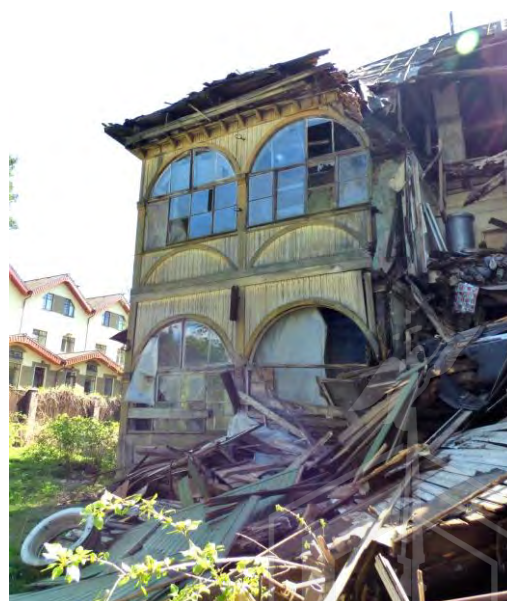
Фото 11. Объект после обрушения в 2018 г.
