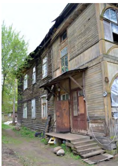
Фото 8. Восточный фасад Объекта после обрушения в 2018 г.
