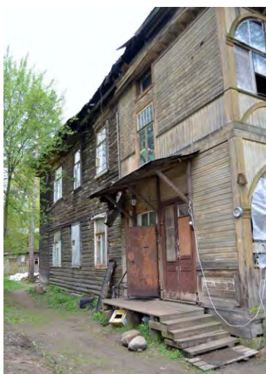
Фото 8. Восточный фасад Объекта после обрушения в 2018 г.
