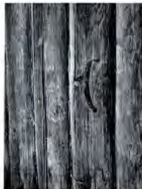
11. Фригмент фасада объекта культурного наследия. Сохранившиеся элементы потолокных конструкций
