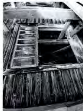
12. Фригмент фасада объекта культурного наследия. Состояние окопных заплотений
