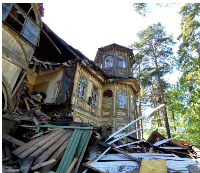
Фото 10. Объект после обрушения в 2018 г.
