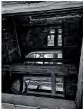
15. Состояние интерьера северо-западной башни
