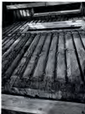
9. Фрагмент фасада объекта культурного наследия. Состояние бревенчатых стен
