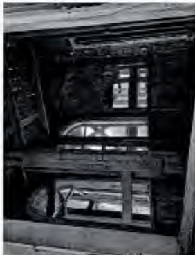
15. Состояние интерьера северо-западной башни
