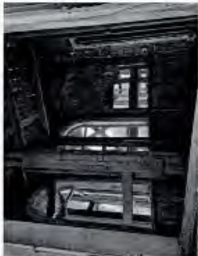
15. Состояние интерьера северо-западной башни
