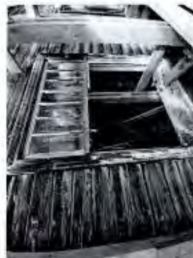
12. Фрагмент фасада объекта культурного наследия. Состояние окопных заплотений
