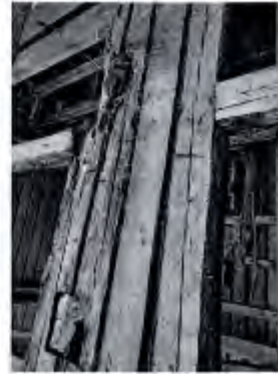
8. Фригмент фасада объекта культурного наследия. Состояние бревенчатых стен
