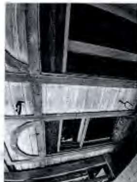
10. Фригмент северо-западной балки. Состояние стен и отделки
