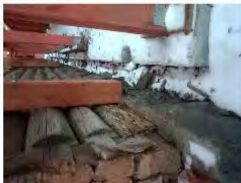
Фото 50. Восточный фасад, покосы
