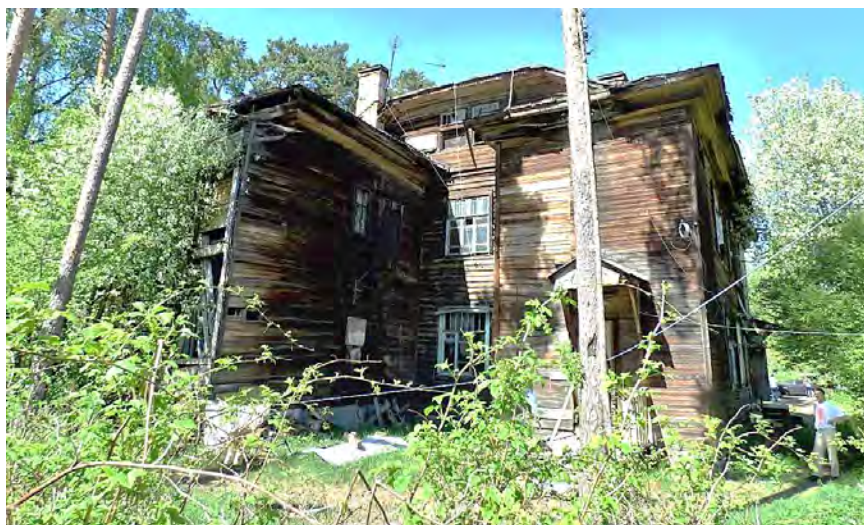
Фото 7. Часть южного фасада Объекта после обрушения в 2018 г.
