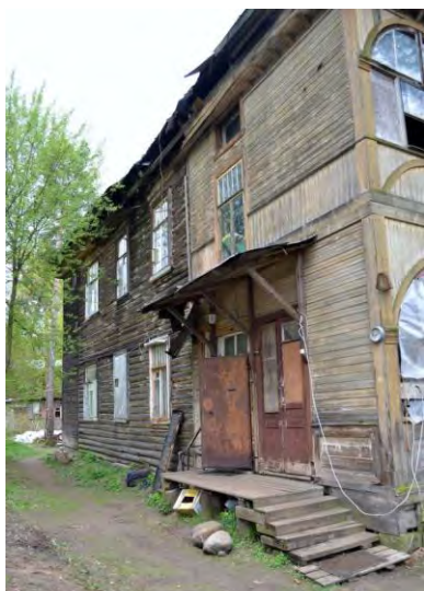
Фото 8. Восточный фасад Объекта после обрушения в 2018 г.
