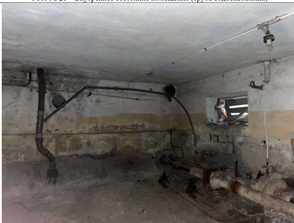
Фото № 22 – Внутреннее состояние помещения (канализационная труба)
