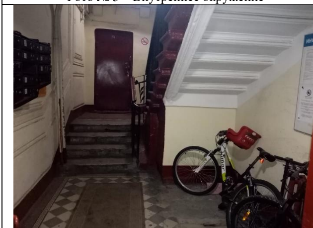
Фото № 7 – Внутреннее состояние помещения общего пользования (лестничная клетка)
