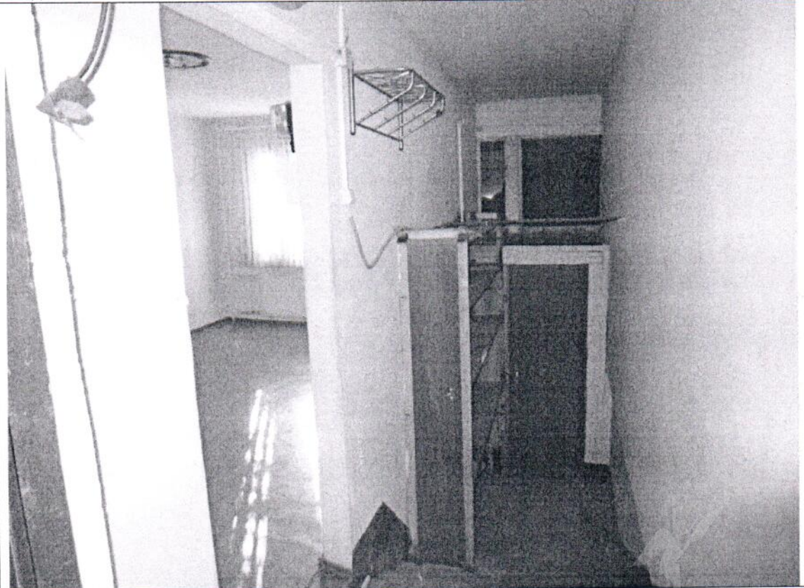
Описание: дверной проем между ч.п. 1 и 3 Объекта переоборудован в проем без дверного блока
