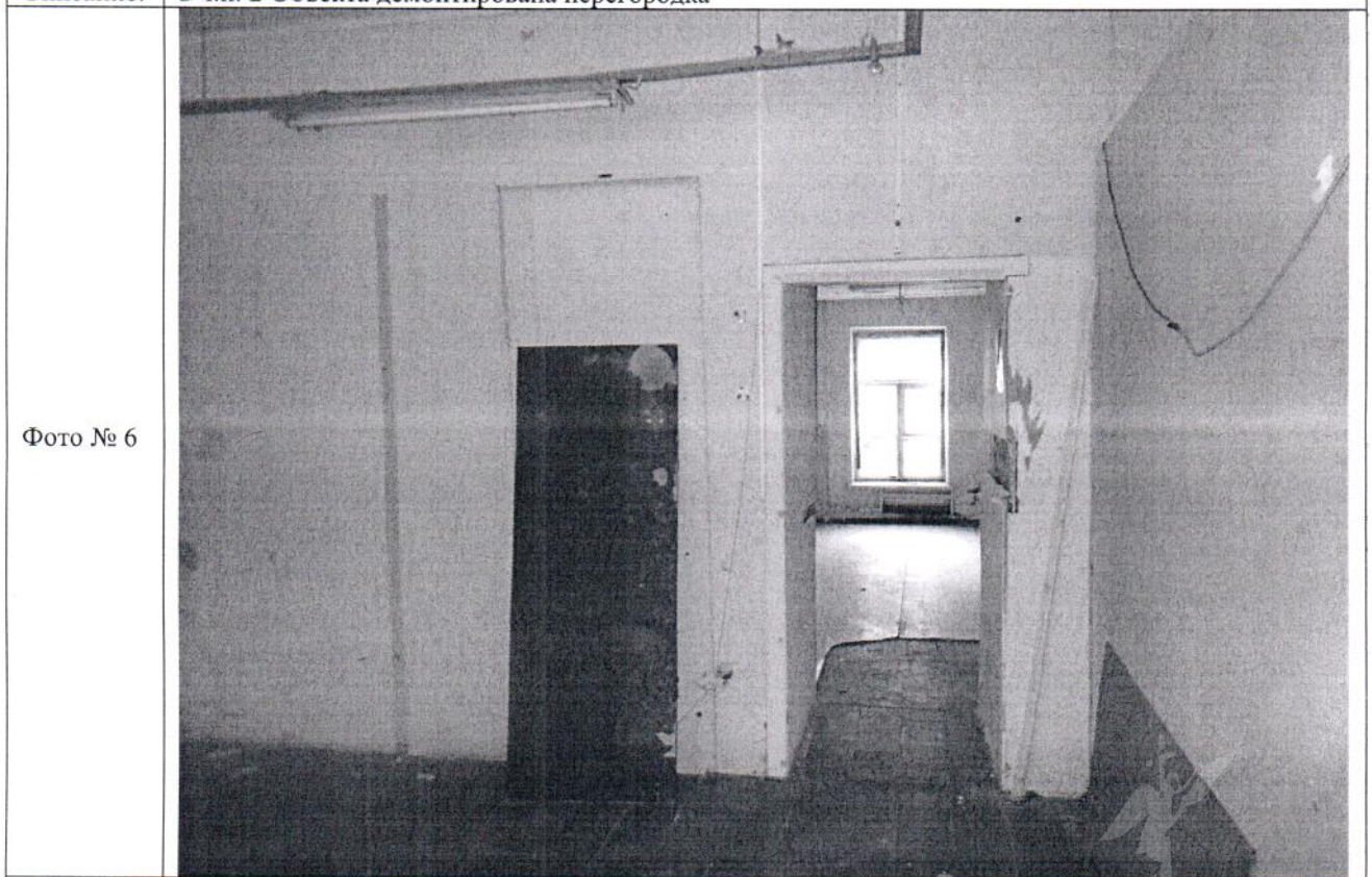
Описание: между ч.п. 10 и 2 Объекта дверной проём переоборудован в проём без дверного блока
