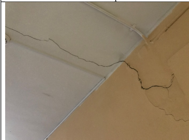
Фото 11. Часть помещения 1. Состояние стен и потолка.
