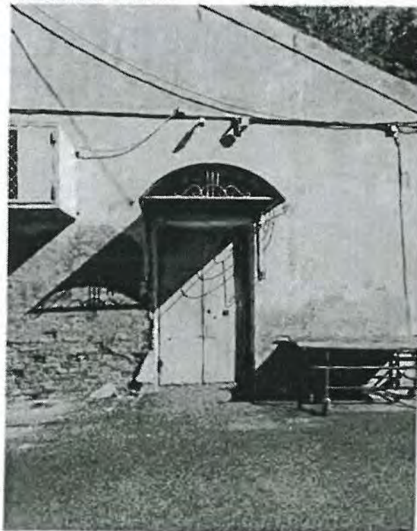
5.9. Фрагмент южного фасада. Камеры видеонаблюдения
