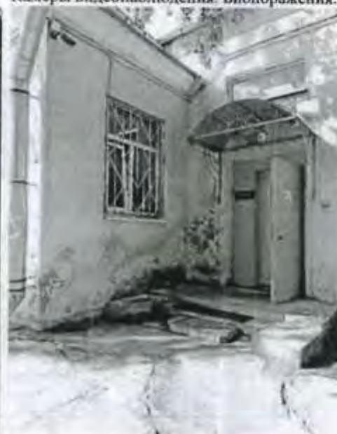
5.6. Крыльцо восточного фасада. Решетка. Камеры видеонаблюдения. Биопоражения.
