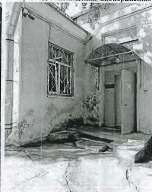
5.6. Крыльцо восточного фасада. Решетка. Камеры видеонаблюдения. Биопоражения.
