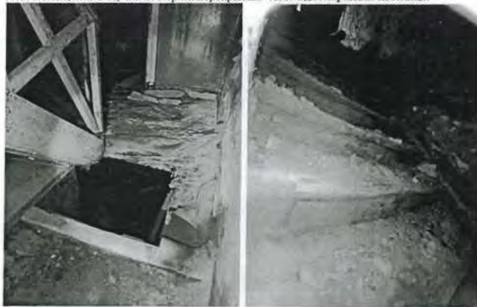
7.15. Помещение 1-Н, ч.п. 1. Утрата перекрытия. 7.16. Одномаршевая лестница.
