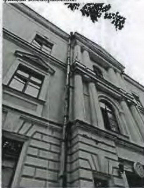
1.8. Фрагмент центральной части северного фасада. Биопоражения.
