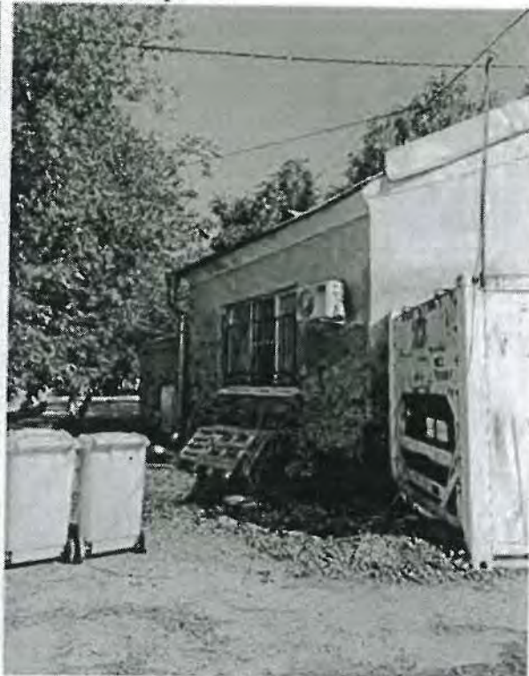
5.8. Фрагмент западного фасада. Утрата штукатурного и окрасочного слоев. Металлические решетки на оконных проемах. Кондиционер.
