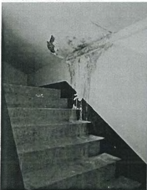
6.23. Двухмаршевая лестница в южной части здания. Следы намокания.
