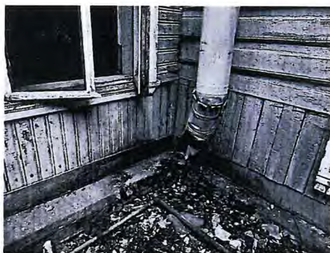
10. Фрагмент восточного фасада объекта культурного наследия. Состояние цоколя и водосточных конструкций
