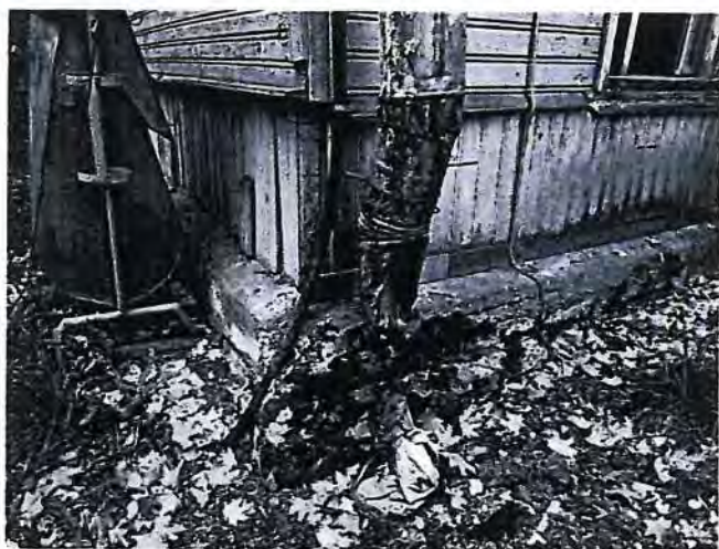
9. Фрагмент восточного фасада объекта культурного наследия. Состояние цоколя и водосточных конструкций
