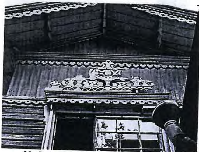
29. Фрагмент западного фасада объекта культурного наследия. Состояние декоративных элементов
