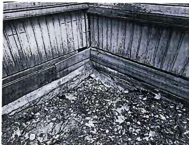
8. Фрагмент западного фасада объекта культурного наследия. Состояние цоколя
