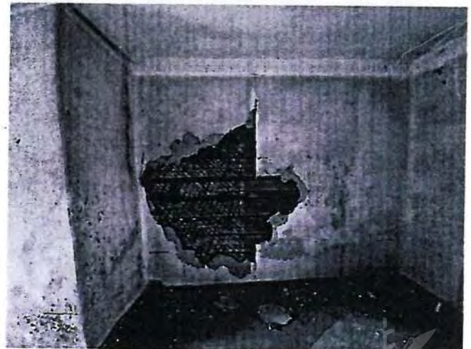
42. Интерьеры. Состояние стен (дефекты отделочных слоев)
