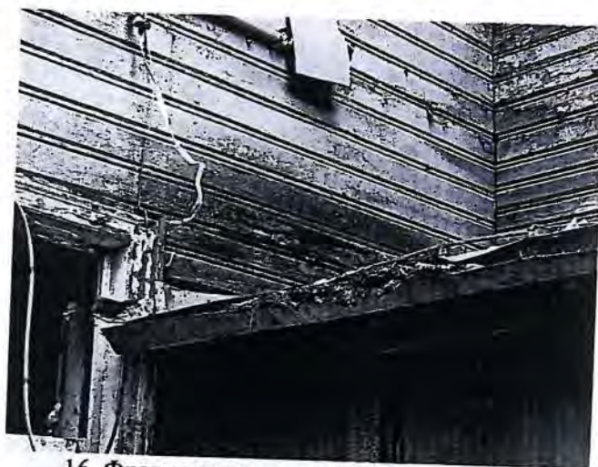
16. Фрагмент восточного фасада объекта культурного наследия. Состояние облицовки
