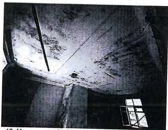
47. Интерьеры. Следы грибковых биопоражений
