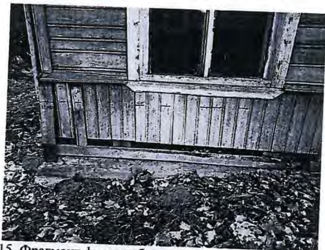
15. Фрагмент фасада объекта культурного наследия. Состояние облицовки
