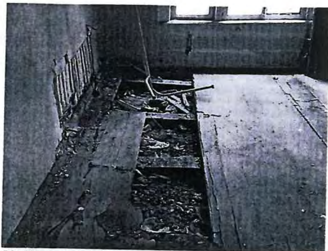
50. Интерьеры. Фрагментарные утраты напольного покрытия
