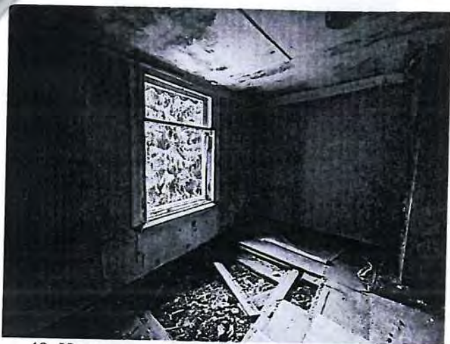
49. Интерьеры. Состояние стен и напольного покрытия
