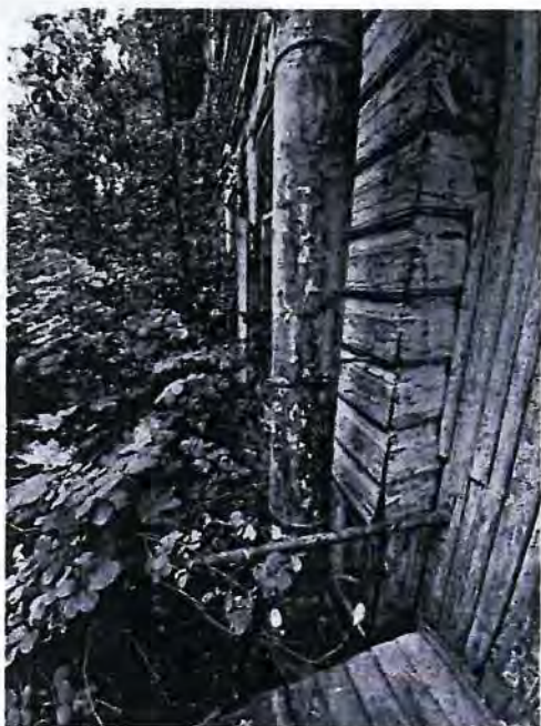
11. Фрагмент восточного фасада объекта культурного наследия. Состояние водосточных конструкций
