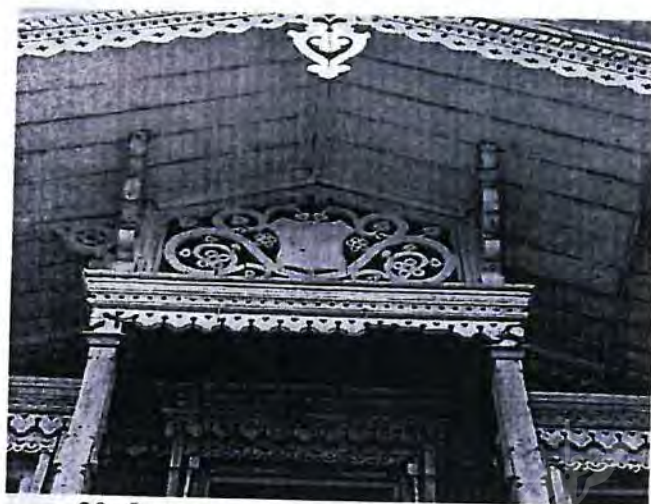
30. Фрагмент западного фасада объекта культурного наследия. Состояние декоративных элементов
