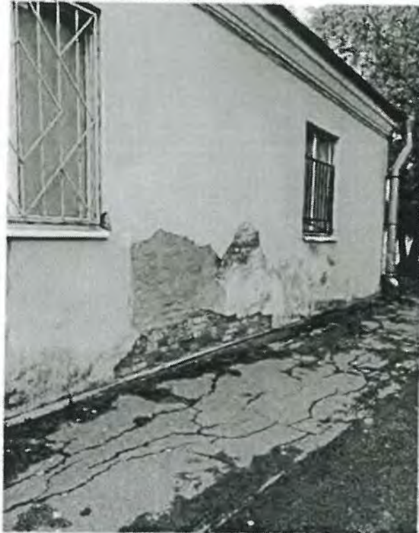
5.7. Фрагмент восточного фасада. Утрата штукатурного и окрасочного слоев. Металлические решетки на оконных проемах. Камера видеонаблюдения.
