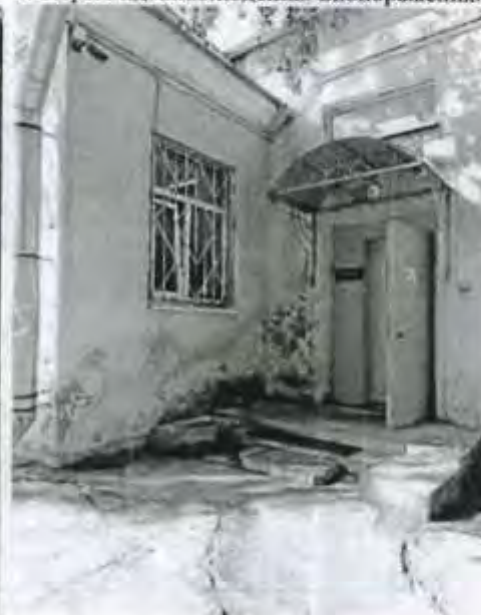
5.6. Крыльцо восточного фасада. Решетка. Камеры видеонаблюдения. Биопоражения.
