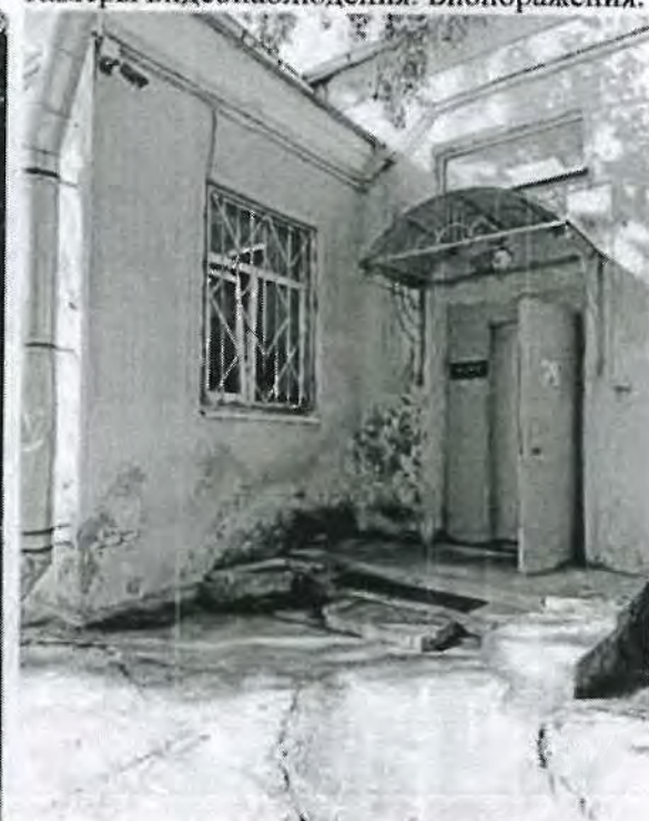
5.6. Крыльцо восточного фасада. Решетка. Камеры видеонаблюдения. Биопоражения.
