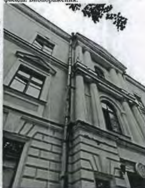
1.8. Фрагмент центральной части северного фасада. Биопоражения.
