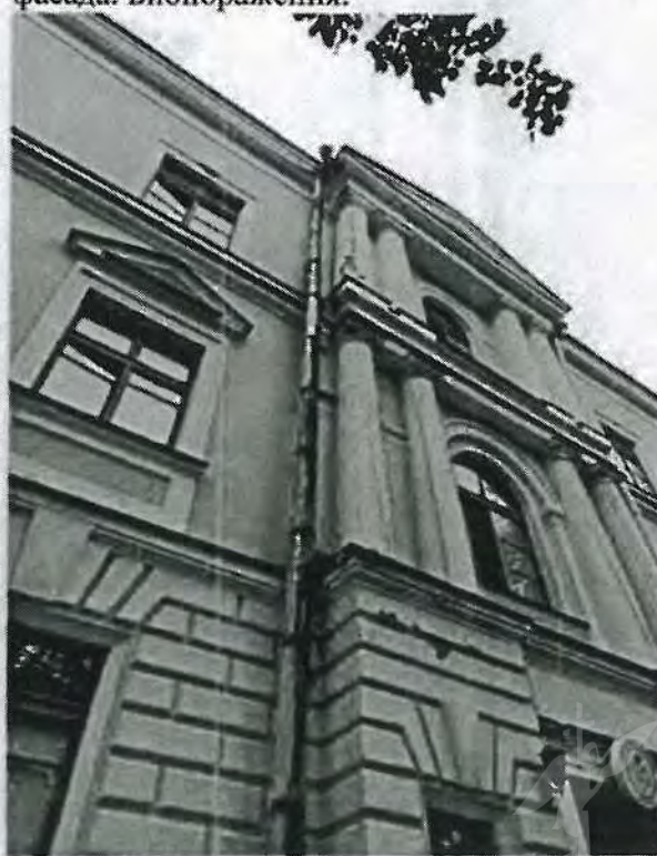
1.8. Фрагмент центральной части северного фасада. Биопоражения.
