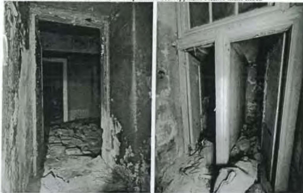
7.13, 7.14. Помещение 1-Н, ч.п. 5, 7. Загрязнения, деструкция отделочных слоев
