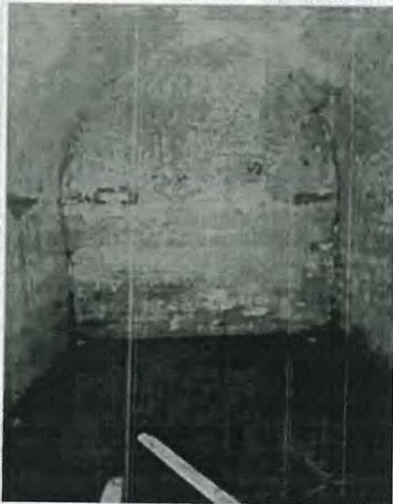
4.8. Помещение 1-Н, ч.п. 2. Частично затоплено.
