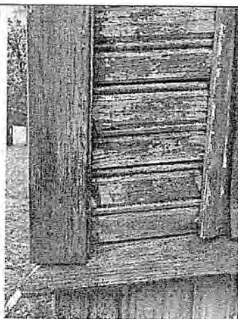
14. Состояние отделки фасадов
