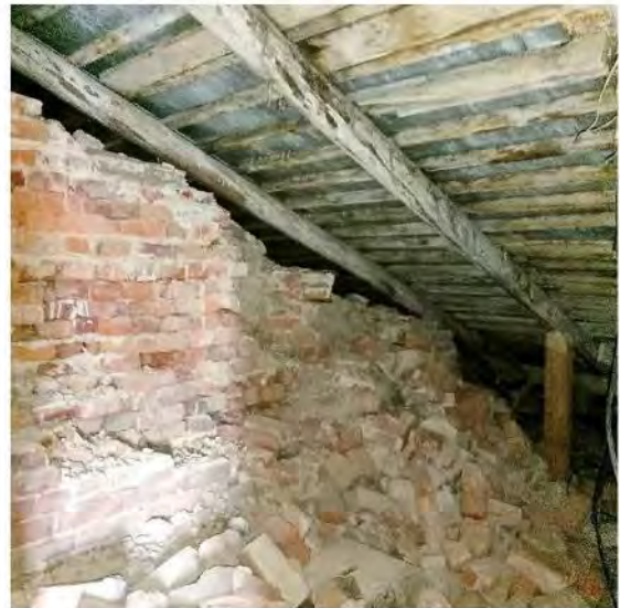
Фото 32. Вид чердачного (подкровельного) пространства, разрушение кладки
