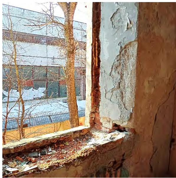
Фото 20. Один из оконных проемов на 2 этаже
