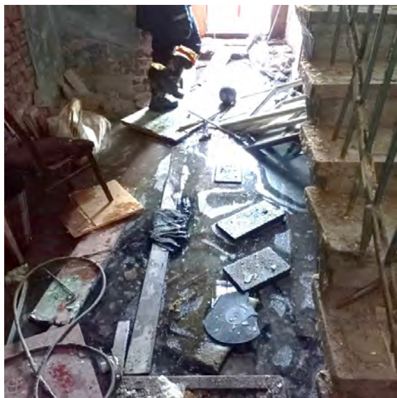
Фото 13. Затопление ч.п.1 и ч.п.2 пом.1ЛК
