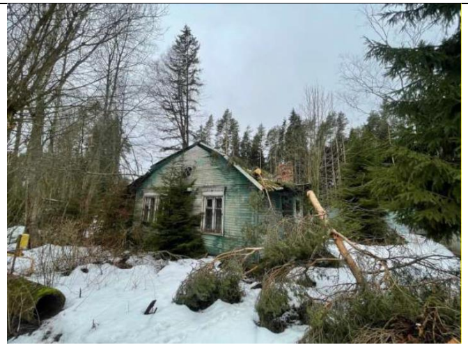
Фото 2. Общий вид Объекта оценки со стороны Елового переулка. Точка подключения к газоснабжению
