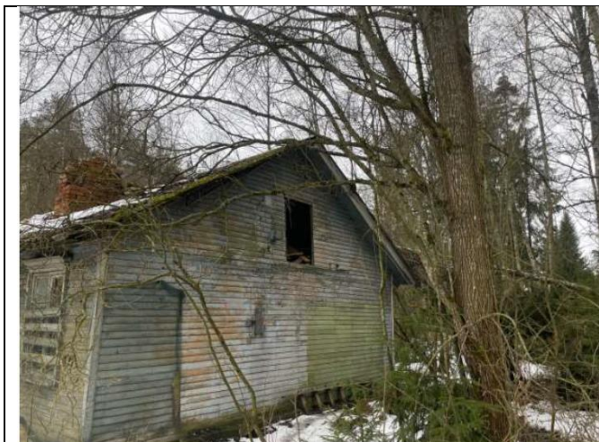
Фото 3. Общий вид Объекта оценки со стороны Елового переулка. Точка подключения к газоснабжению
