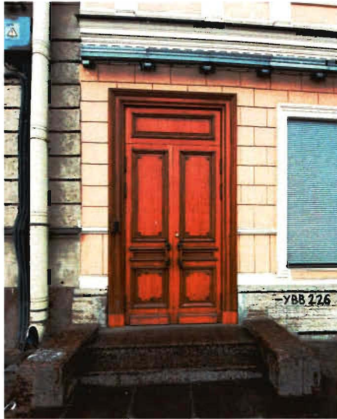
Фото 3. Входная группа (лицевой фасад по Английской набережной). Деревянный (дубовый) портал. Крыльцо из двух гранитных ступеней с глухими гранитными подпорными стенками. Фото выполнено 13.03.2025.
